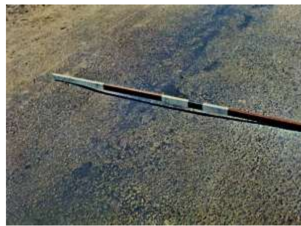
(b) Afundamento local
