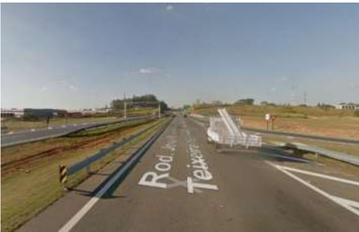
Ausência de “zona livre” e presença de dispositivos de contenção Fonte: Google (2015).
