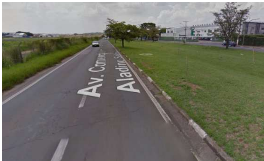
Falta de calçamento – Av. Com. Aladino Selmi (Sta. Mônica) Fonte: Google Street View (2015)
