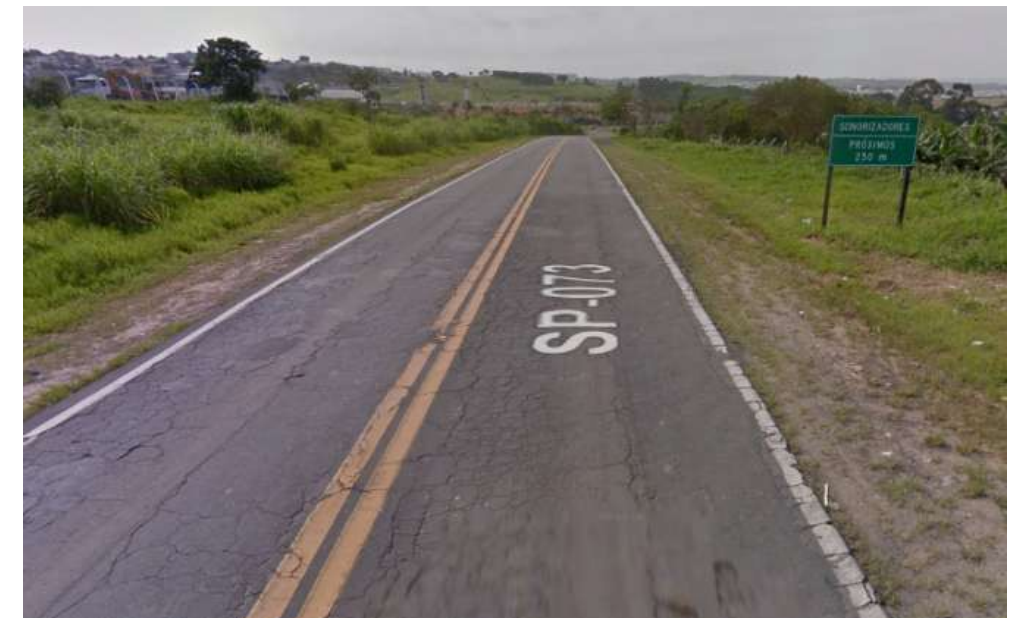
Falta de calçamento e travessias não sinalizadas - Rod. Lix da Cunha -Nova Califórnia
