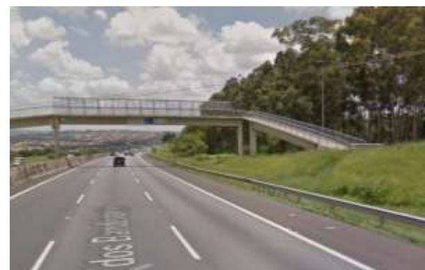
3 – Passarela sem tratamento de acessibilidade.
