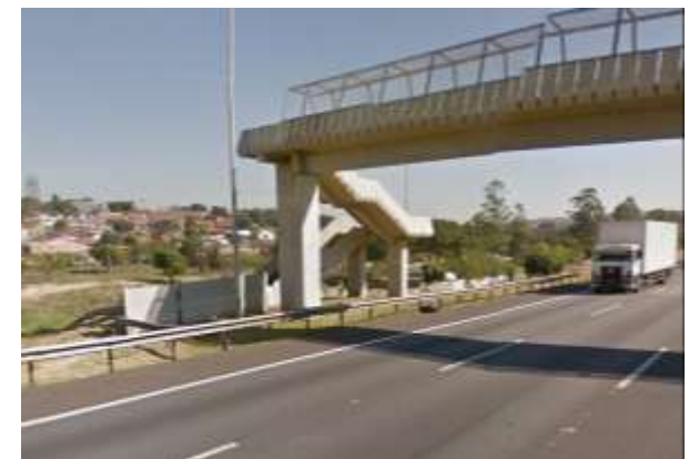
2 – Passarela sem tratamento de acessibilidade.
