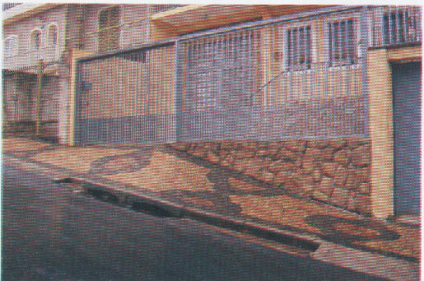
↓ Rebaixamento irregular, que prejudica o caminhar e causa acidentes
